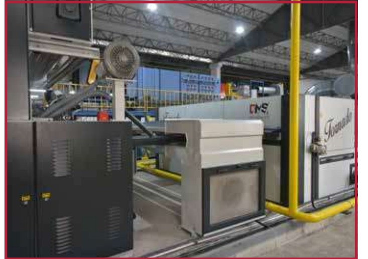
Hava Soğutma Fan Bölümü / Exit Cooling Unit
