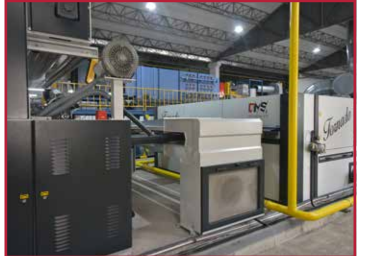
Hava Soğutma Fan Bölümü / Exit Cooling Unit
